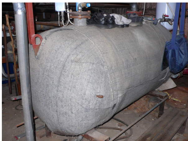
Joonis 3.1 Lasteaia soojussõlme mahtsoojaveeboiler
